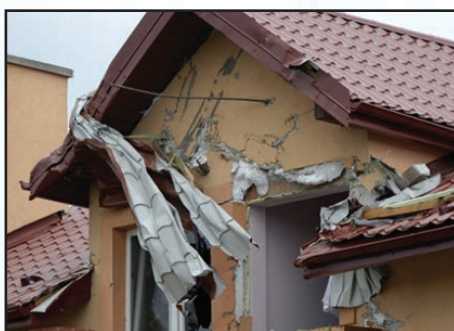
Poważne uszkodzenia blachodachówki przy wietrze wiącym z prędkością zaledwie 70 km/h!
